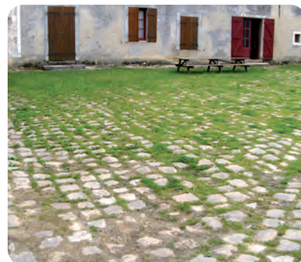
LES PAVÉS SANS JOINT LAISSENT S'INFILTRER L'EAU
